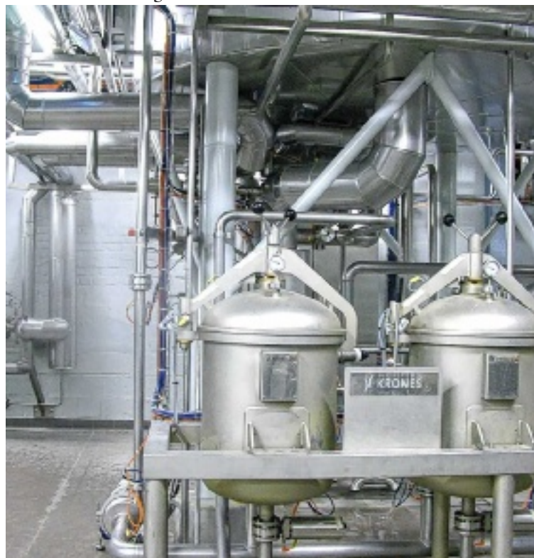
Les cuves sont reliées entre elles par tout un système de tuyauterie, située en bas de la salle de brassage.
